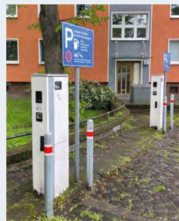
Die Ladeinfrastruktur wird von der WGH-Herrenhausen stetig ausgebaut, wie hier im Bussilietweg in Herrenhausen.
